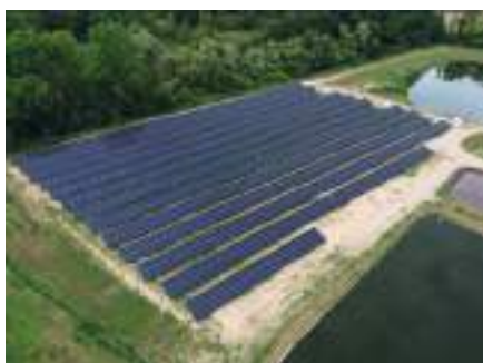
INSTALLATION PHOTOVOLTAÏQUE AU SOL 1 000 KWC
