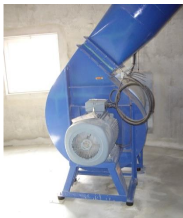
Figure 7 : ventilateur dans un silo
