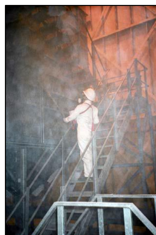
Figure 6 : Emissions de particules lors d'un traitement des locaux avec Silicosec®. Source : (Cook, Collins, et Collins 2004)
