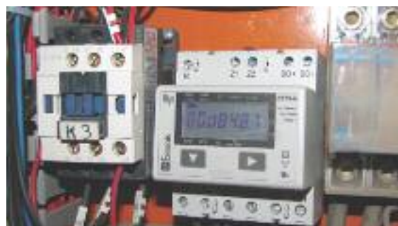
> Capteur de consommation électrique installé dans l'armoire électrique d'un bâtiment suivi.
